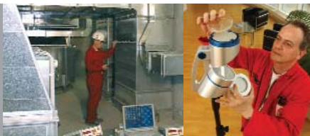
Inspektion von RLT-Anlagen
